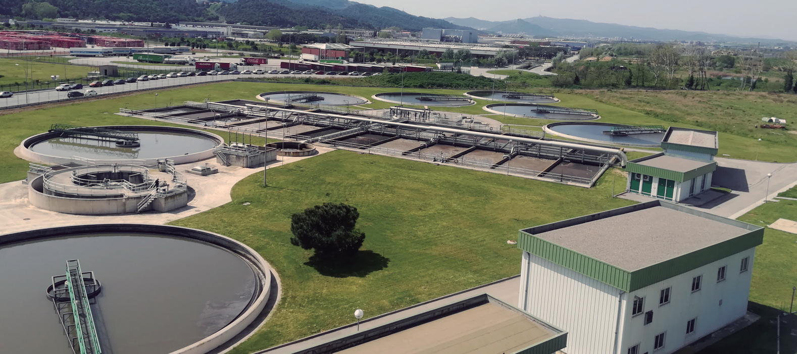
Vista aèria de l'EDAR Montornès del Vallès
