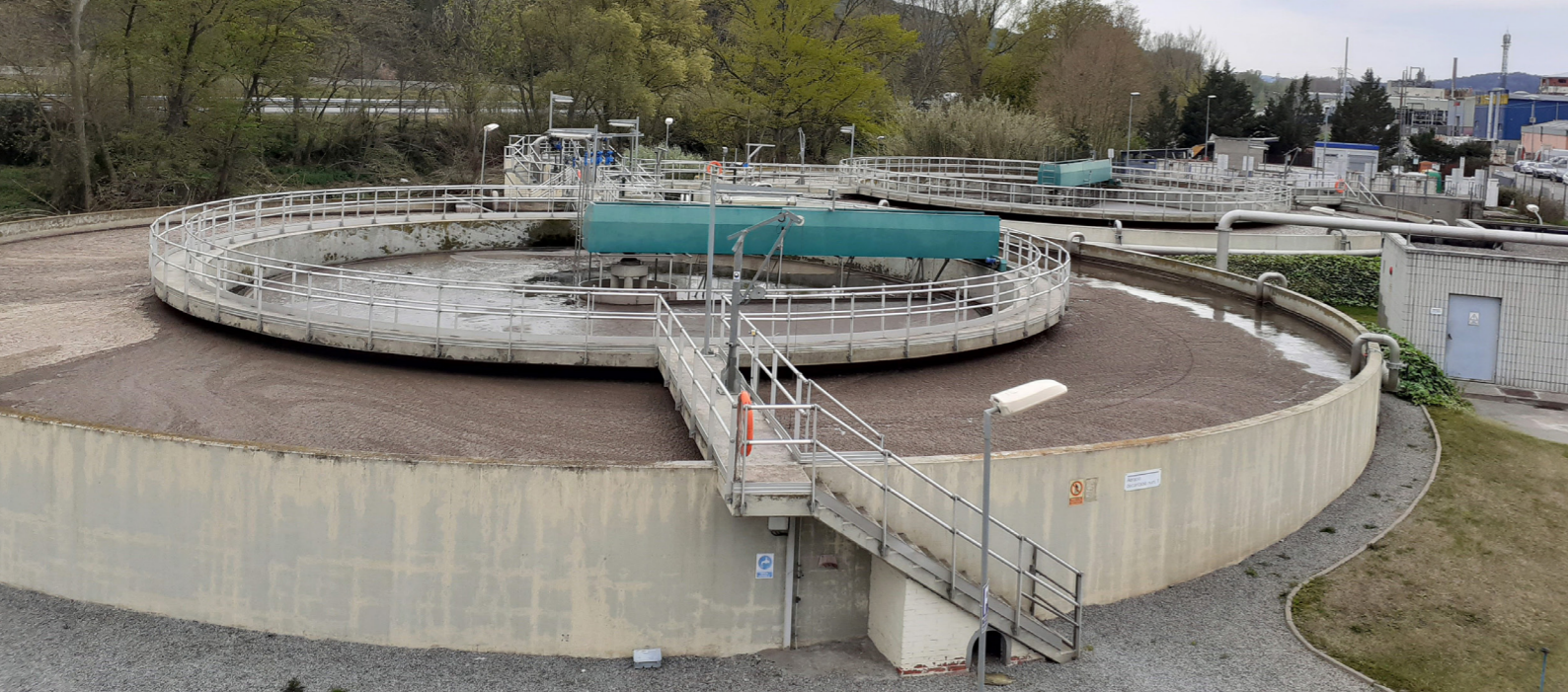
Decantador de l'EDAR Sant Celoni
