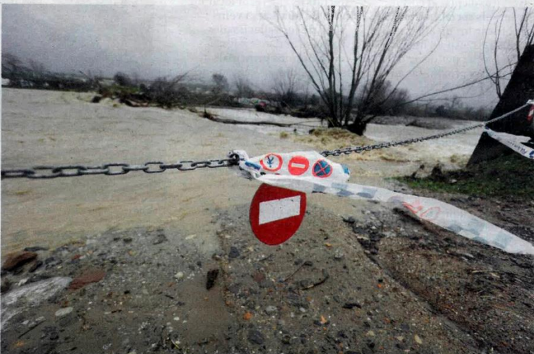
El gual d'Arquímedes, a Palou, és la zona on el riu ha fet caure un tram de 50 metres de l'escullera de formigó
